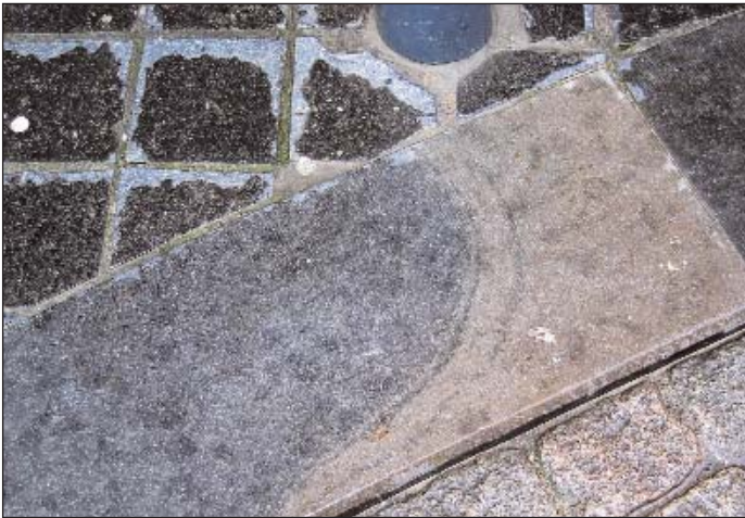
Beige verkleuring van boordsteen (Petit Granit) met karakteristiek dolomitisatiefront. Hasselt
